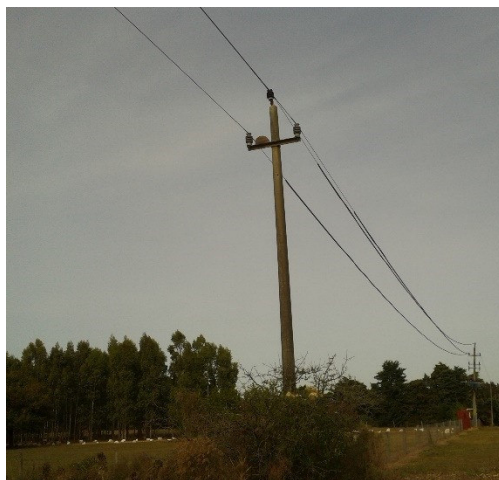
Foto de línea de media tensión (6 o 15 mil Voltios)
